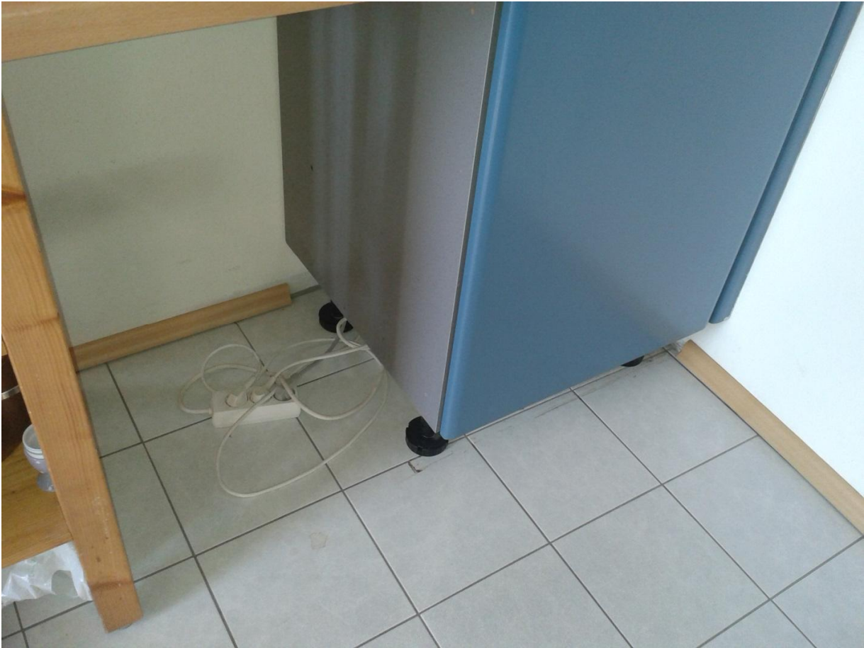
Bild 4: KG ohne Zwangsbelüftung, „original“
